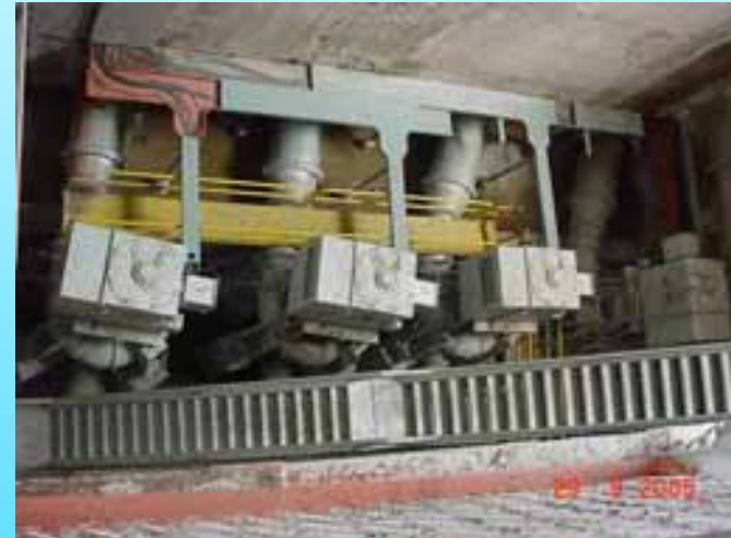
Estação de Bombeamento EB 1
