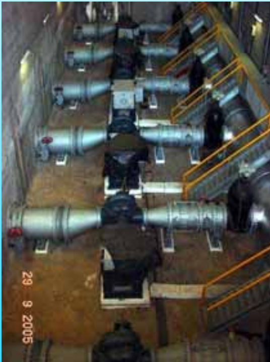
Estação de Bombeamento de Itaipava ( Q= 6,0 m^3/s )
